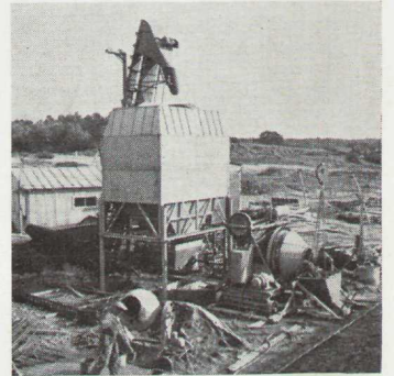
Fig. 7. Betongstation med elevator, grusjickor och betongblandare på mark.
